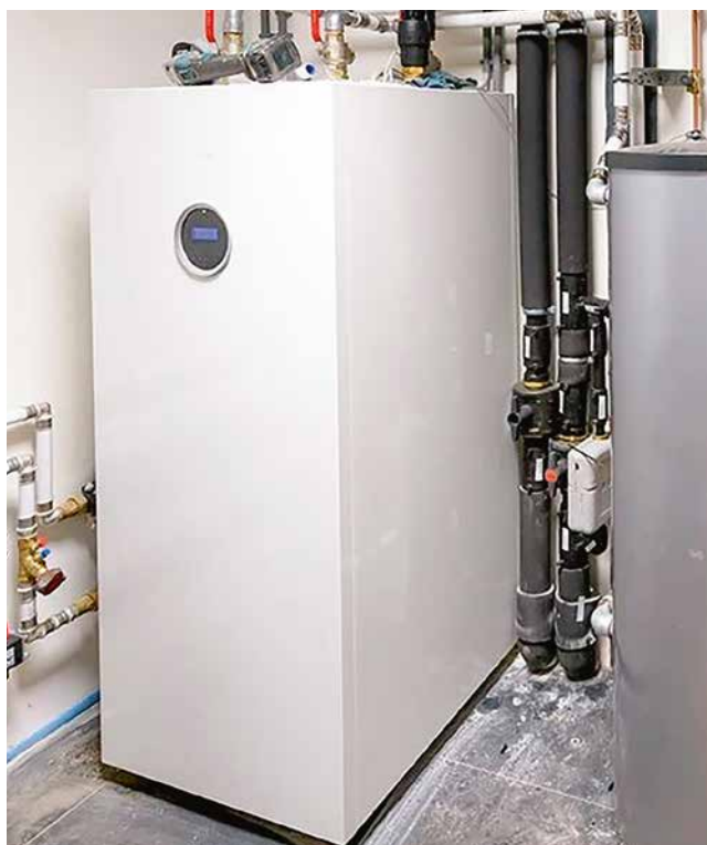
Een aparte warmtepomp met boilervat (gescheiden systeem)
