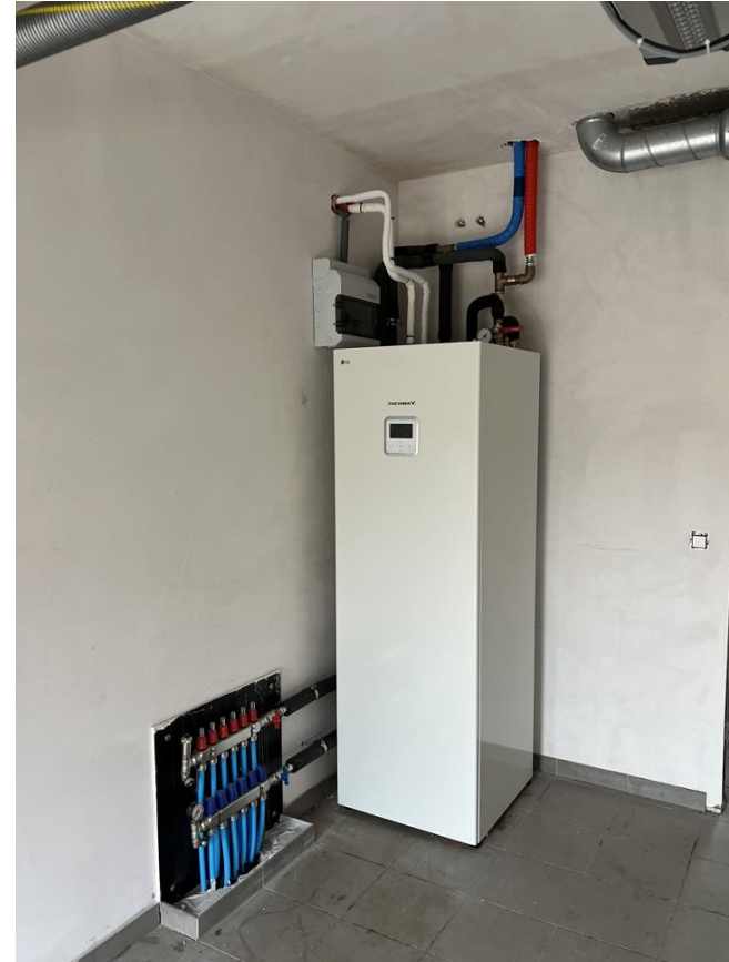
Voorbeeld installatie all-in one warmtepomp
