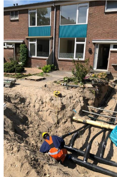
Warmteleidingen in de straat
