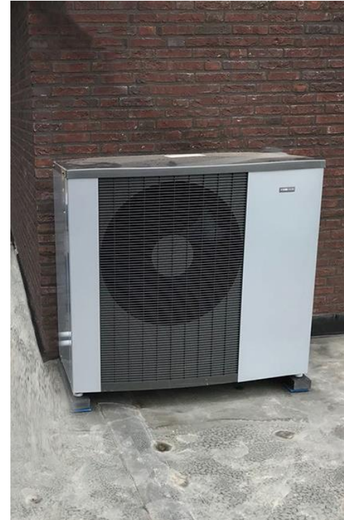
Buitenunit op plat dak
